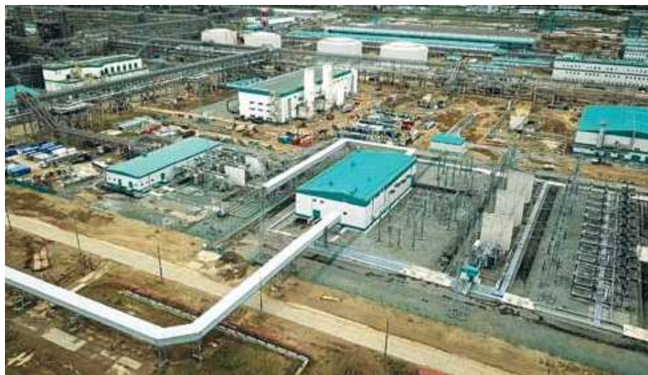
ГПП-1 110 кВ. «ЗабСибНефтехим». Тобольск, 2018 год
